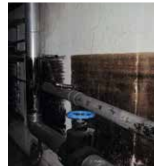
Ölschaden nach dem Hochwasser
